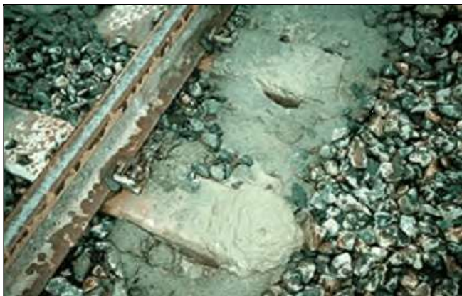
Figura 01. Bombejamento de finos em ferrovia.
